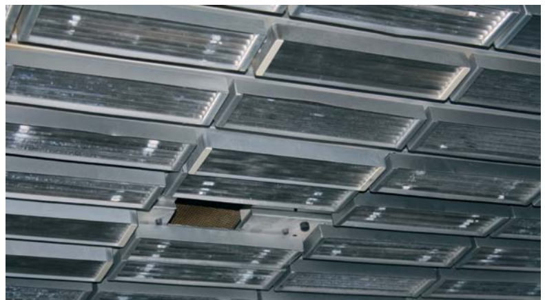
Abb. 1: Heizfeld bestehend aus Strahlern, angeordnet in Spalten und Reihen. 1 Heizfeld wurde für das Sichtfeld der Kamera entfernt.
